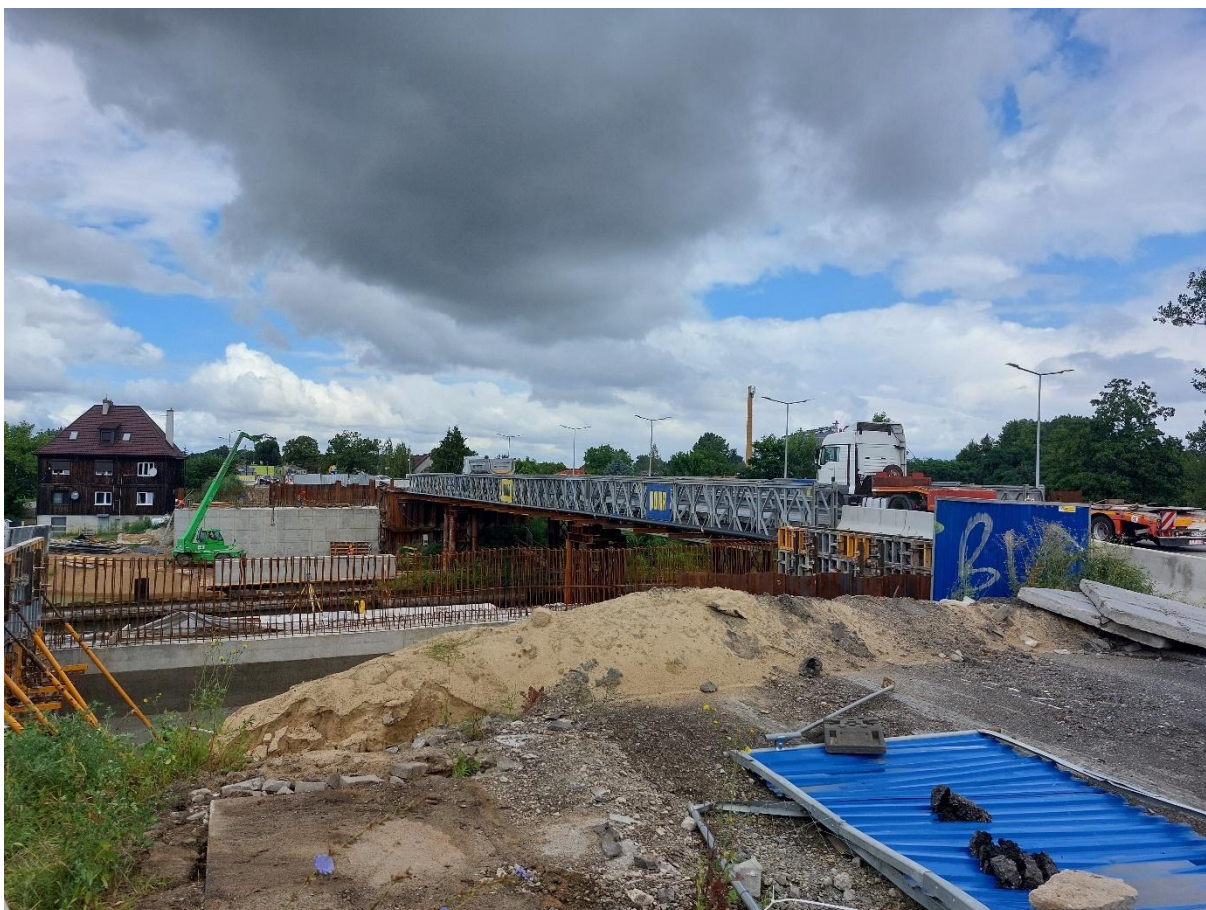
Ryc. 7: Remont przeprawy nad rzekami Noteć i Gwda w ciągu drogi nr 11 (05.08.2024 r.)
